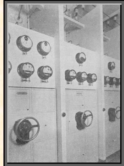
Část ústř. rozvodné stanice Přerov
